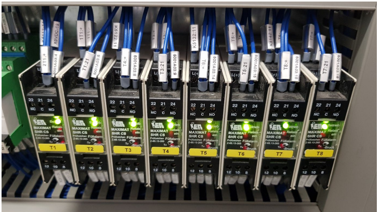
Przykład nr 2. poprawnego typu, poprawnie wykonanych oznaczników.
